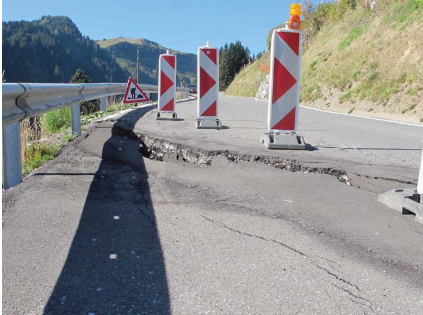
Un nouvel affaissement de l'ordre de 20 centimètres s'est produit au mois d'août, à environ 150 mètres de la bifurcation entre Champoussin et les Crosets. La zone sera assainie, notamment grâce à un maillage en bois dans le sol. LE NOUVELLISTE
